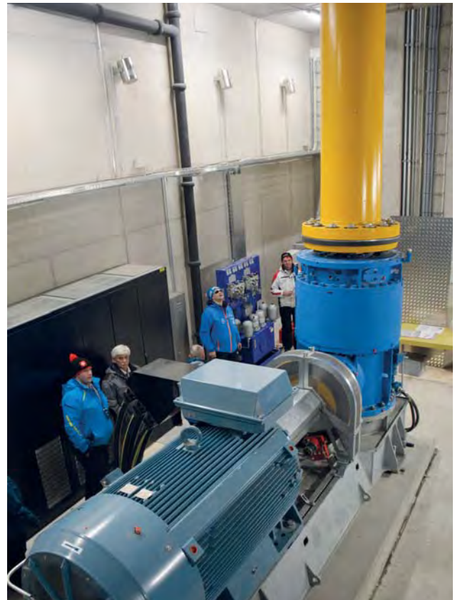
Sorgt für Bewegung: der Antrieb der neuen Seilbahn.
