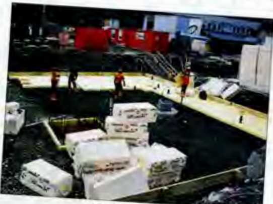
Die Bodenplatte für das Erdgeschoss des Mehrzweckgebäudes Wyden II ist fertig betoniert.
